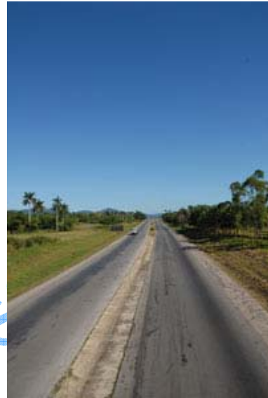
Bild 15: Auf der kubanischen Autobahn
